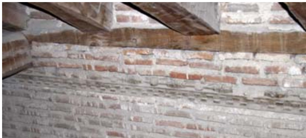
Restos de armadura sobre la nave sur
