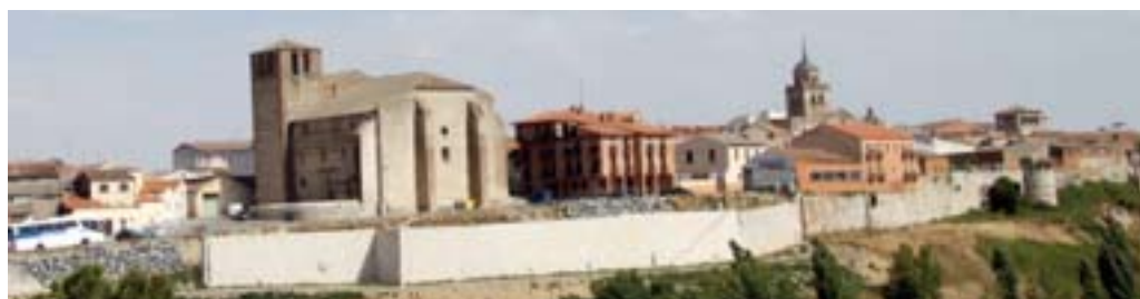
Muralla de Arévalo en la zona del Arevalillo durante la restauración de Francisco Jurado de 2011
