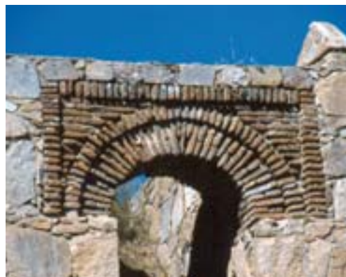
Arco y alfiz de entrada al castillete del torreón nº 49, frente oeste, de la muralla de Ávila
